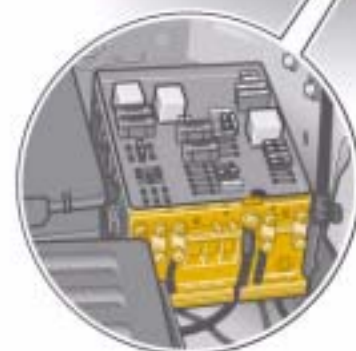
Boîte à fusibles primaires dans le compartiment moteur gauche
