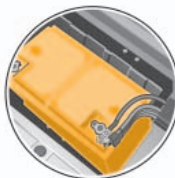
Porte-fusibles (SA), à droite sur la batterie, visible uniquement après dépose
